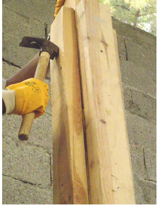
Resim 35: Şaplamanın üst dikmeye çakılması
